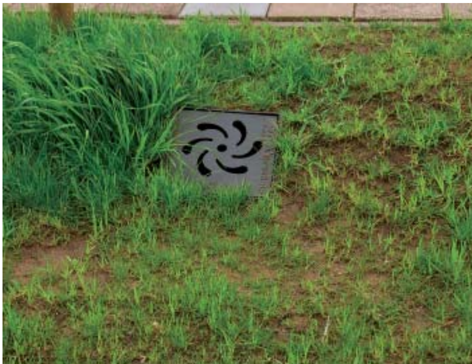
Figuur 50 Slokop in talud
