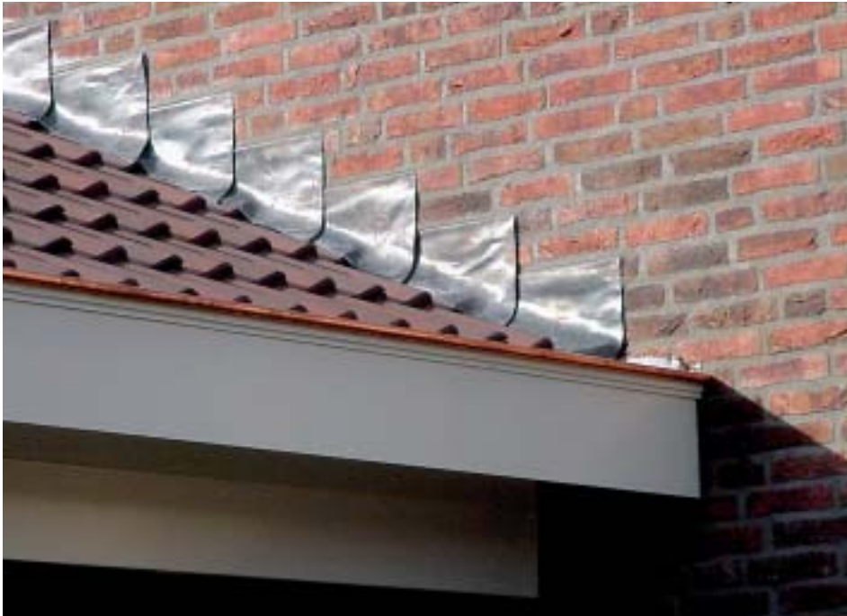
Figuur 45 Uitlopende constructiematerialen als loodslabben en koperen dakgoten zijn moeilijk te verbieden
