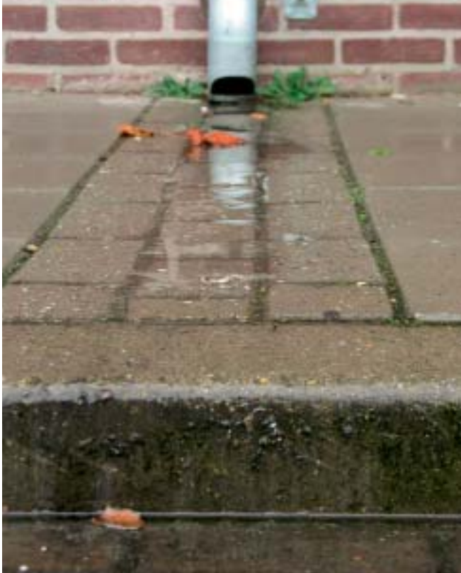
Figuur 49 Afvoer over het trottoir met een ondiepe goot
