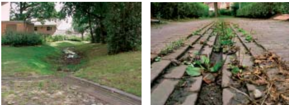
Figuur 47 Links: de wadi is deels dichtgeslibt door bladval, Rechts: het onkruid groeit goed in de goot
